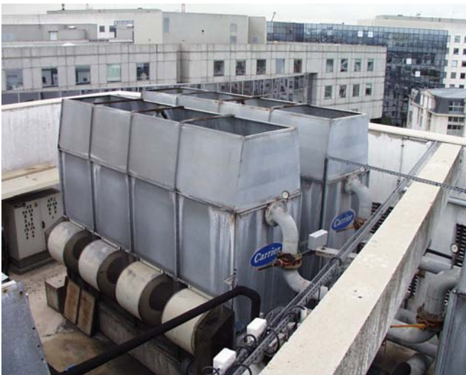
Les installations techniques des bâtiments peuvent devenir des sources de pollutions, par exemple ici des tours aéro-réfrigérantes, qui peuvent disséminer des légionelles dans l'environnement.
